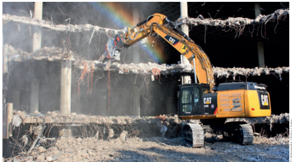
Gudrun Sack, Vorstandsmitglied, stellte in Ihrer Begrüßung dar, wie beim Abriss von Gebäuden bereits aufgewendete Graue Energie zerstört wird, die dann für den Neubau erneut anfällt.
