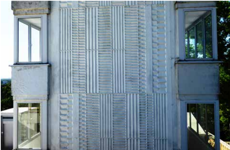
Die Auffrischung der Fassadenhaut steht noch aus.
