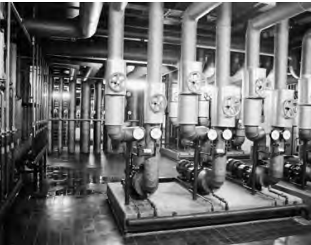
Überholungsbedürftige Klimatisierungsgeräte im Zwischengeschoss des ICC, Foto: Robert Frank
